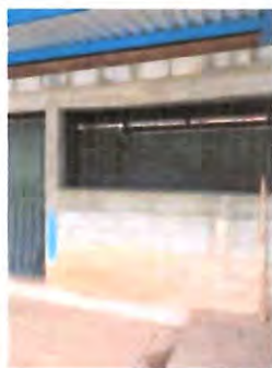
PINTURA EN MUROS POR MAL ESTADO
